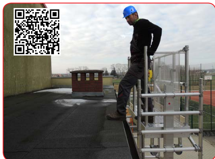
Può essere anche usato come sistema di accesso e di sbarco in quota (tetto, copertura, piano).
